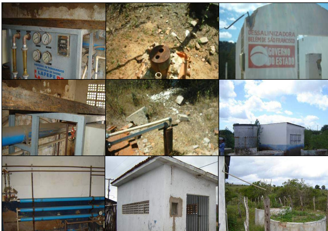
Foto 01 - Estado de Conservação de Sistemas De Dessalinização em Pernambuco Fonte: SRHE 2007
